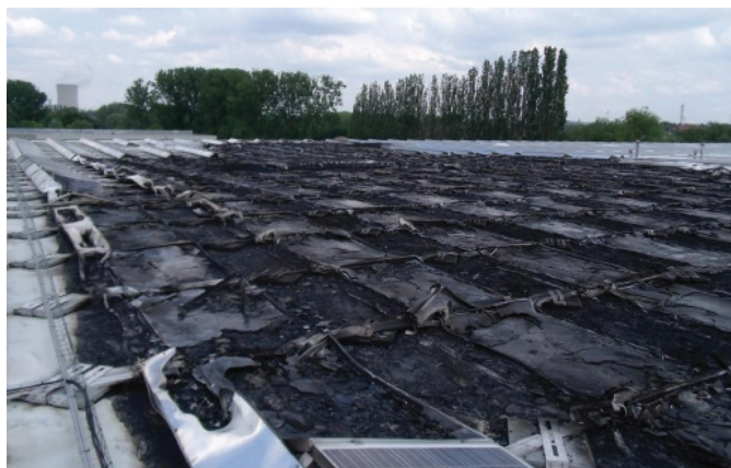
Вид крыши после повреждения
