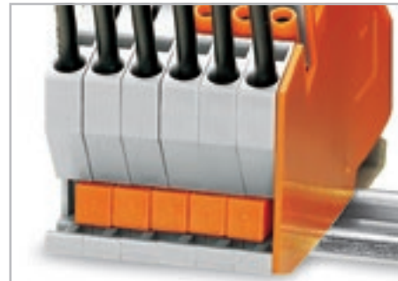
Подготовленная для испытательных схем трансформаторов тока клеммная колодка со вставленными закорачивающими перемычками.
