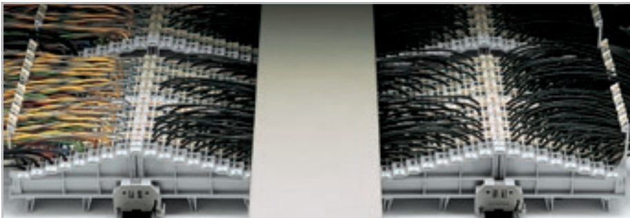
Пример слева: Основные кабели проведены через фиксаторы на стороне соединения справа: Управляющие кабели проведены между фиксаторами центр: Кабели для сторон коммутации
