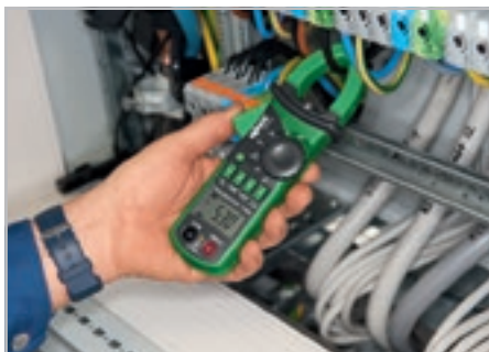
Измерения тока в распределительном шкафу
